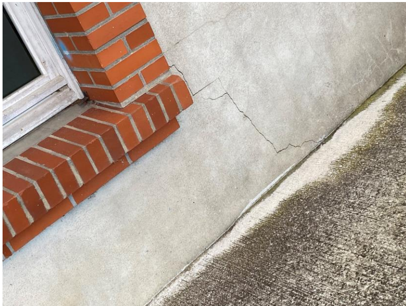
Chaleur et retrait gonflement argile
